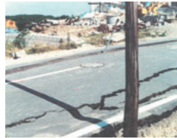
舗装に亀裂の入った道路 (仙台市博物館所蔵)
