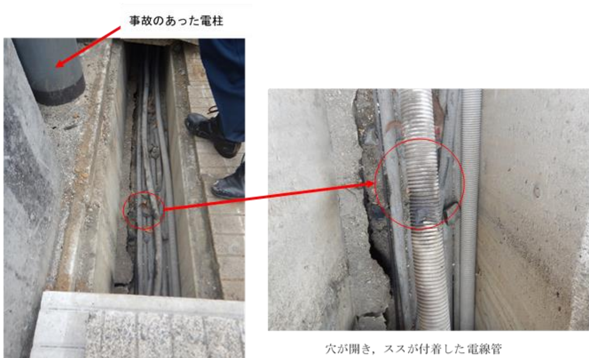
図－8 弱電用ケーブル状況
