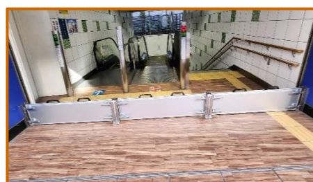
東西線仙台駅に配備した止水板
