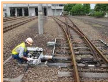
電気転つ機検査
