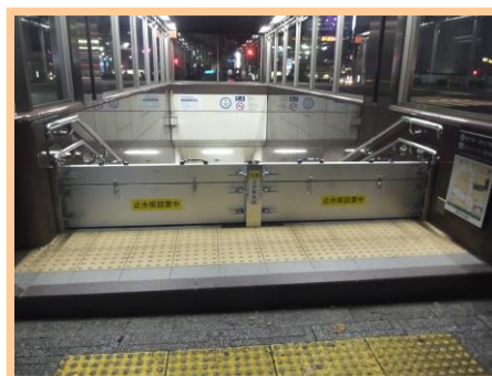
南北線仙台駅に配備した止水板
