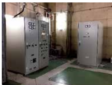
非常用発電設備（地下鉄）
