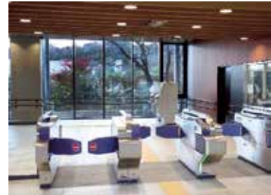
東西線自動出改札設備
