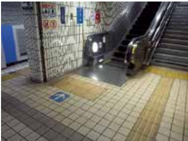
昇降機設備（エスカレーター）
