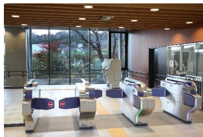
東西線自動出札設備
