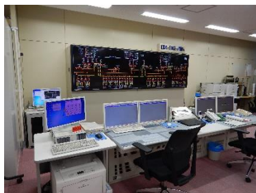
東西線電力管理システム
