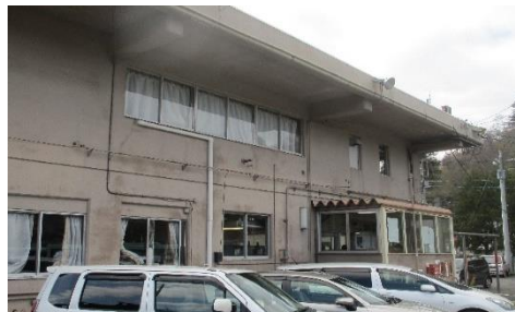
老朽化が進む川内営業所
