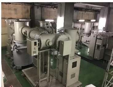
駅舎電気設備（特別高圧受電設備）
