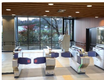
東西線自動出札設備
