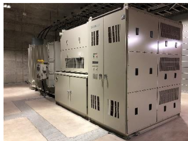
電力吸収装置
