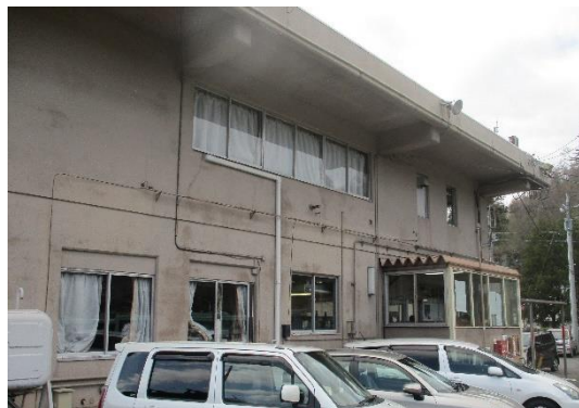
老朽化が進む川内営業所
