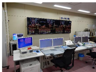
東西線電力管理システム
