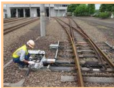
電気転てつ機検査
