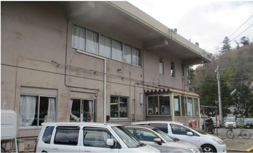
▲老朽化が進む川内営業所
