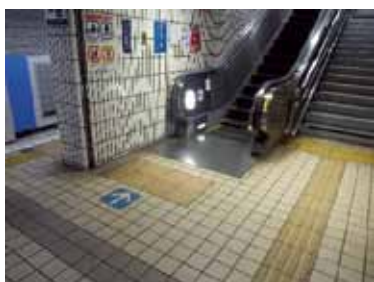
昇降機設備（エスカレータ）
